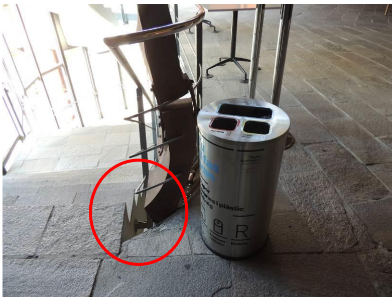
Figures 40. Detall del forat a dalt de l'escala que presenta un perill. TOTALMENT INACCESSIBLES
